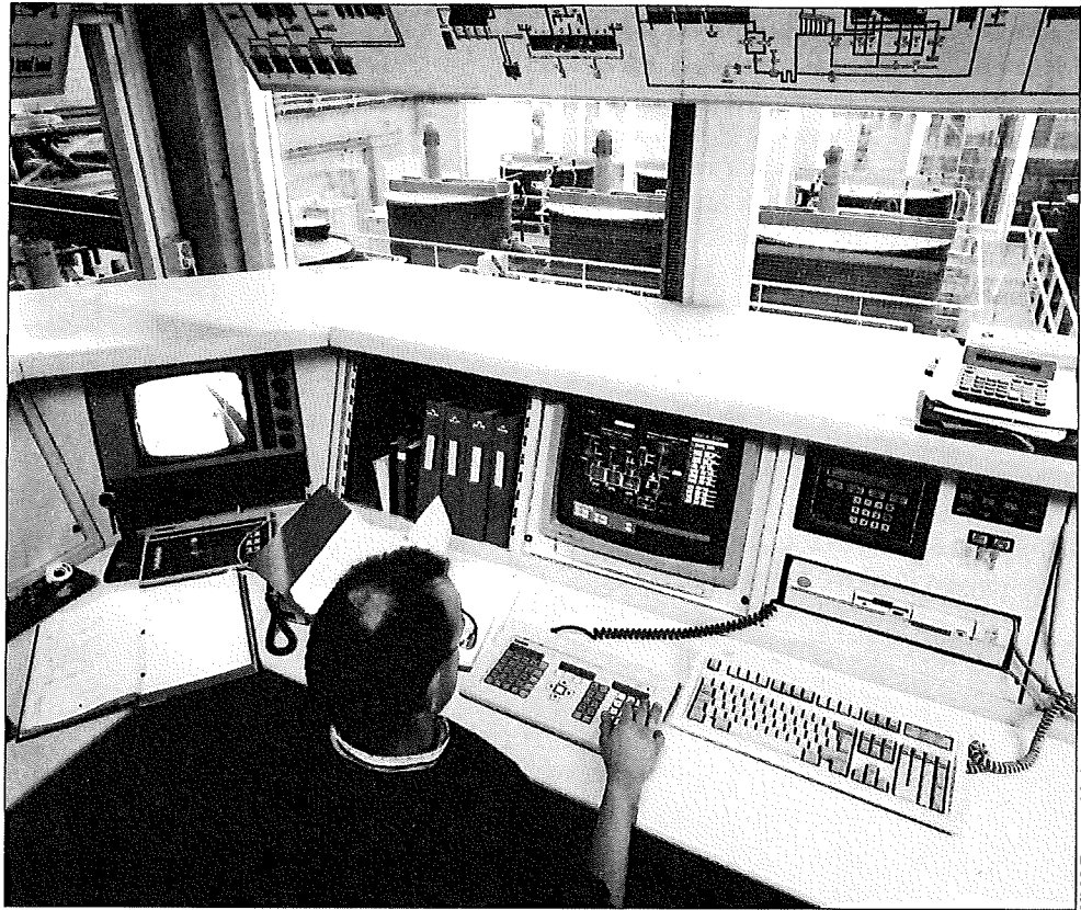
De controlekamer van het KLM Milieu Centrum.
